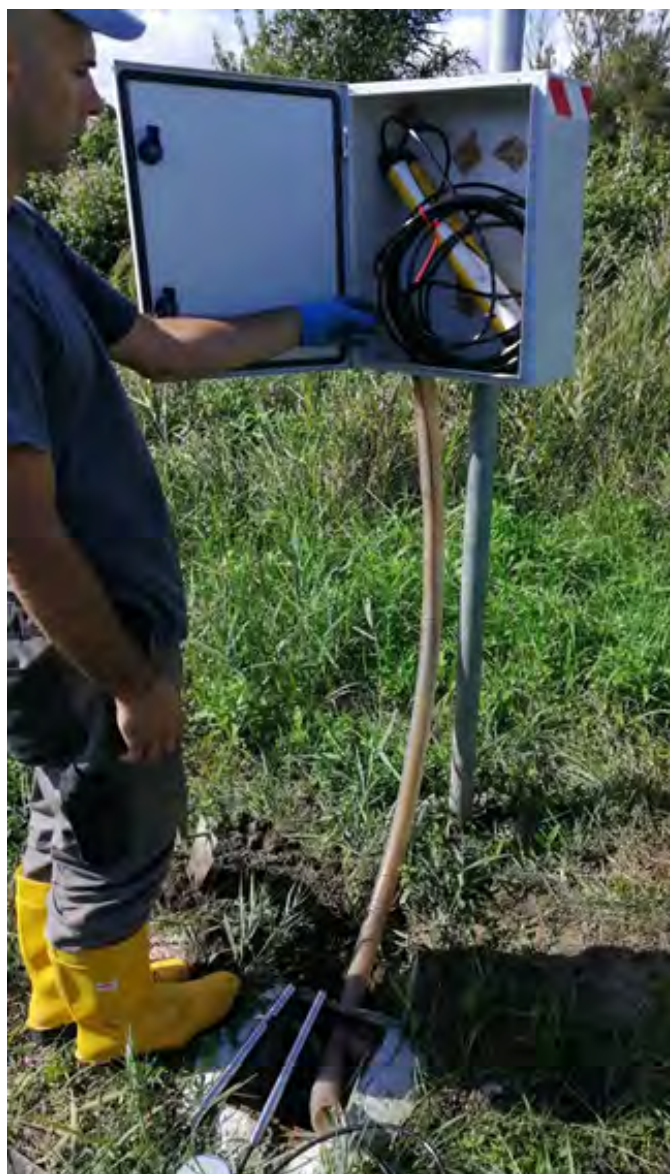
Installazione del sensore
